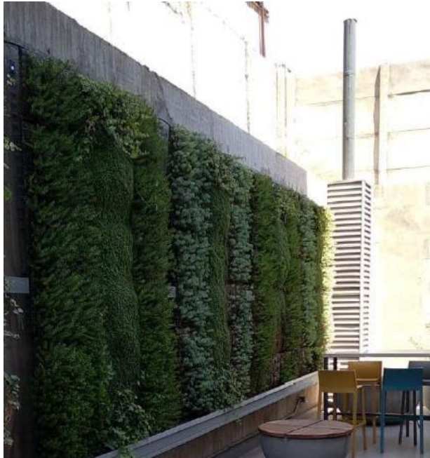
Jardín vertical en patio interior oriente con riego tecnificado, Edificio Rondizzoni II.
