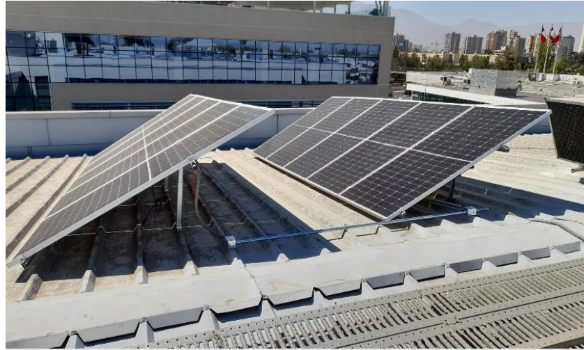
Fotografía 5: Planta solar fotovoltaica, edificio Rondizzoni I.
