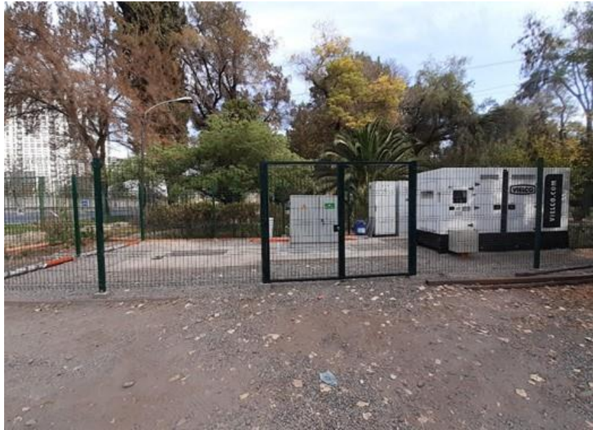
Fotografía 1: Nueva sala eléctrica y nuevo grupo electrógeno en Casa Central
