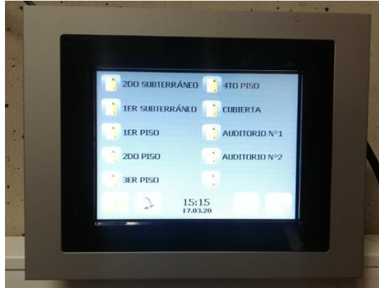
Fotografía 7: Sistema de control centralizado de iluminación, edificio Rondizzoni II.
