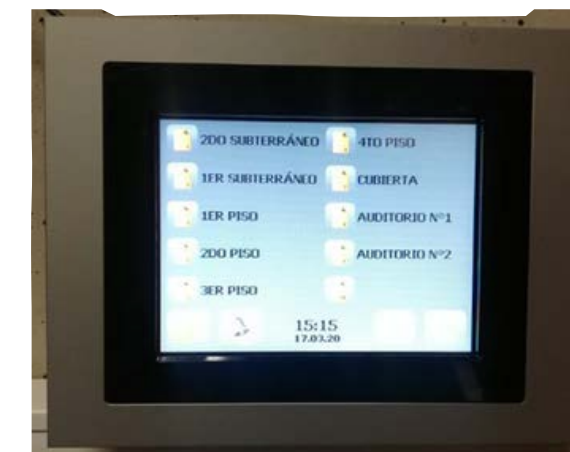
Sistema de control centralizado de iluminación, edificio Rondizzoni II.
