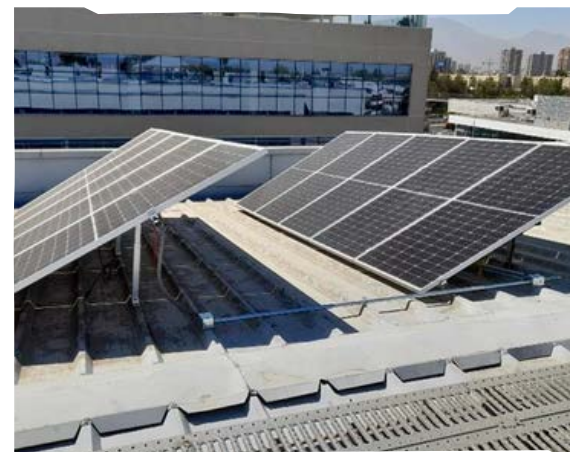
Planta solar fotovoltaica, edificio Rondizzoni I.
