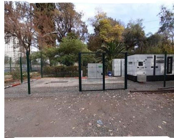
Nueva sala eléctrica y nuevo grupo electrógeno en Casa Central.
